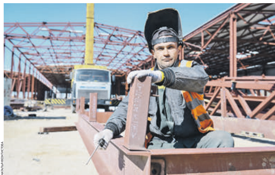
26 марта 13:10 Сварщик Александр Шальнев участвует в строительстве нового электродепо «Лихоборы». Оно будет обслуживать составы поездов на Люблинско-Дмитровской линии метро
