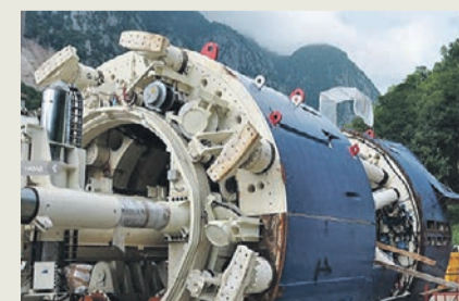
Комплекс LOVAT — ТПК-690 применялся при строительстве инфраструктуры и объектов к олимпиаде «Сочи-2014»
