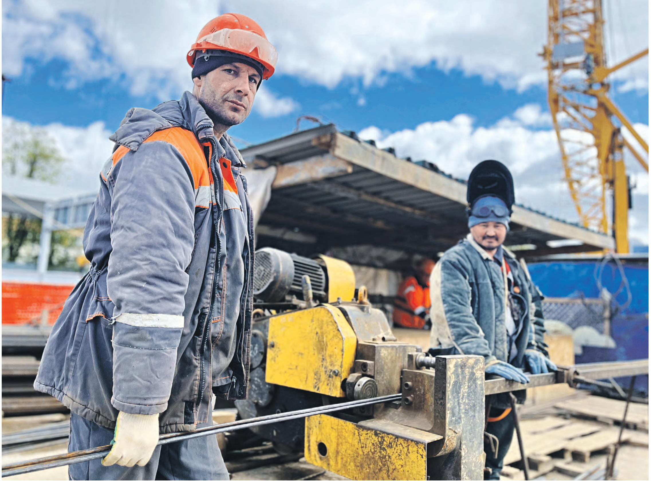
6 мая 2023 года. Строительство станции метро «Аэропорт Внуково». Работы здесь вели круглосуточно. В них принимали участие в том числе арматурщик Федор Муравьев (слева) и сварщик Султан Байбуиснов. Сегодня станция принимает пассажиров, став первой, которую возвели в России у аэропорта. фото: ВАСИЛИСА ЧЕРНЯВСКАЯ
