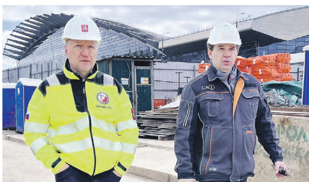
6 мая 12:02 Заместитель мэра Москвы Андрей Бочкарев и глава компании-подрядчика Сергей Воробьев (справа) осмотрели ход строительства станции «Аэропорт Внуково»
