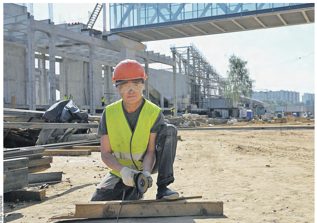
Вчера 09:47 Рабочий Сергей Курашов режет арматуру, необходимую при строительстве транспортно-пересадочного узла «Печатники»
