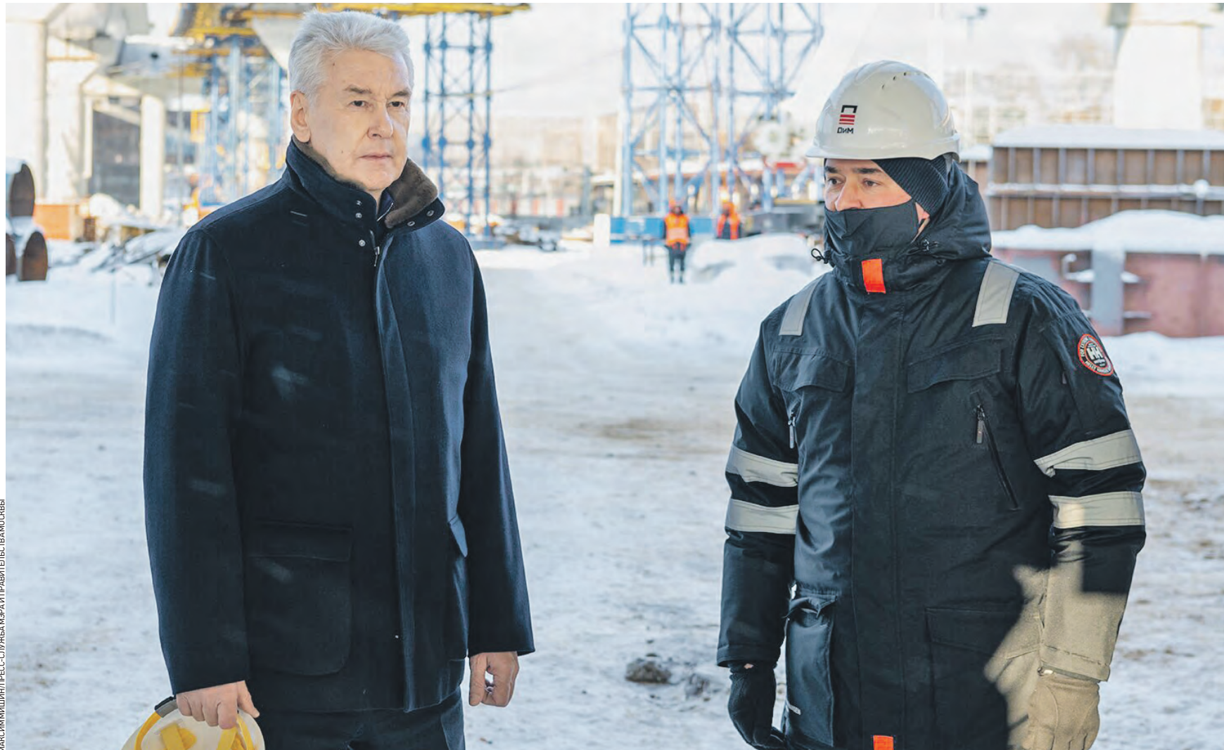
5 февраля 15:24 Мэр Москвы Сергей Собянин (слева) и руководитель команды управления проектами строительной компании Валерий Фабер во время посещения строительства транспортной развязки на пересечении Северо-Восточной хорды с проспектом Мира
