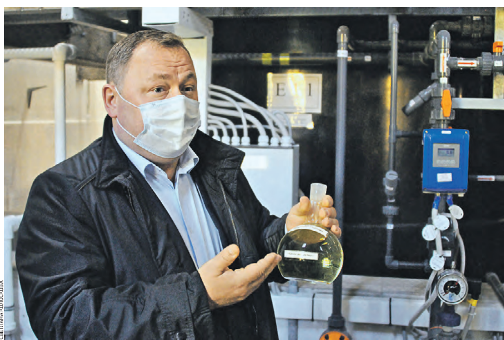
Вчера 11:00 Директор Западной станции водоподготовки Андрей Смирнов показывает колбу с гипохлоритом натрия — безопасным веществом, с помощью которого дезинфицируют воду
