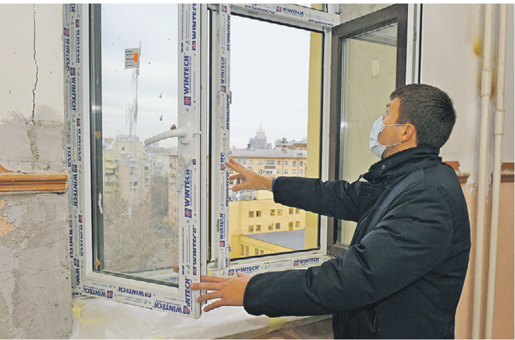
Вчера 12:48 Заместитель генерального директора Фонда капитального ремонта Илья Байдужий осматривает качество установки стеклопакета в подъезде
