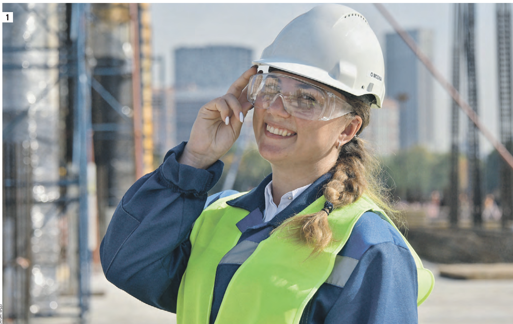
Вчера 11:46 Инженер по технике безопасности Ольга Модина отвечает за соблюдение правил и обеспечение должных условий труда на строительстве Национального космического центра (1) Здесь, согласно проекту (2), будут не только офисы и выставочные площадки, но и общественное пространство, где можно приятно отдохнуть
