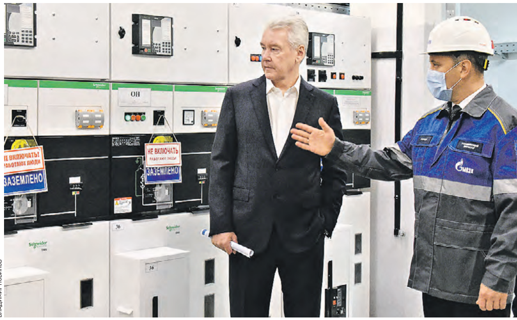
Вчера 12:37 Мэр Москвы Сергей Собянин (слева) и управляющий директор компании «МОЭК» Денис Башук осматривают насосно-перекачивающую станцию «Бирюлево-Борисовская»
