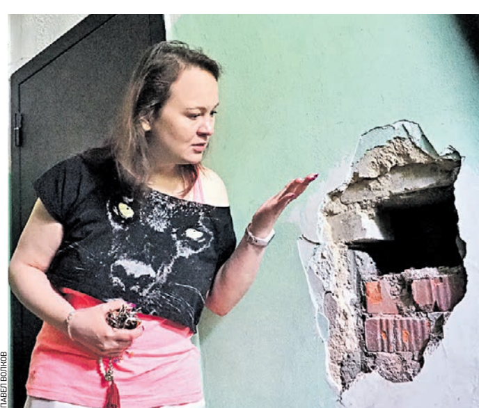
3 июня 11:00 Жительница дома на Лодочной улице Олеся Майорова показывает дыру в стене в своем подъезде
