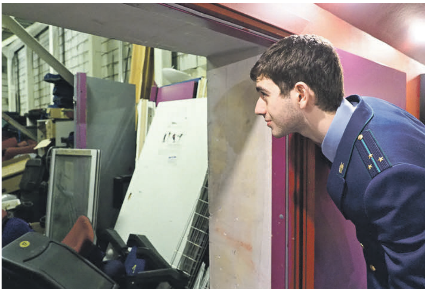
Вчера 14:50 Юрист второго класса прокуратуры Москвы Захар Варданян осматривает подсобное помещение, забитое всяческой рухлядью. Руководству кинотеатра выдано предписание установить там датчики и автоматическую систему пожаротушения
