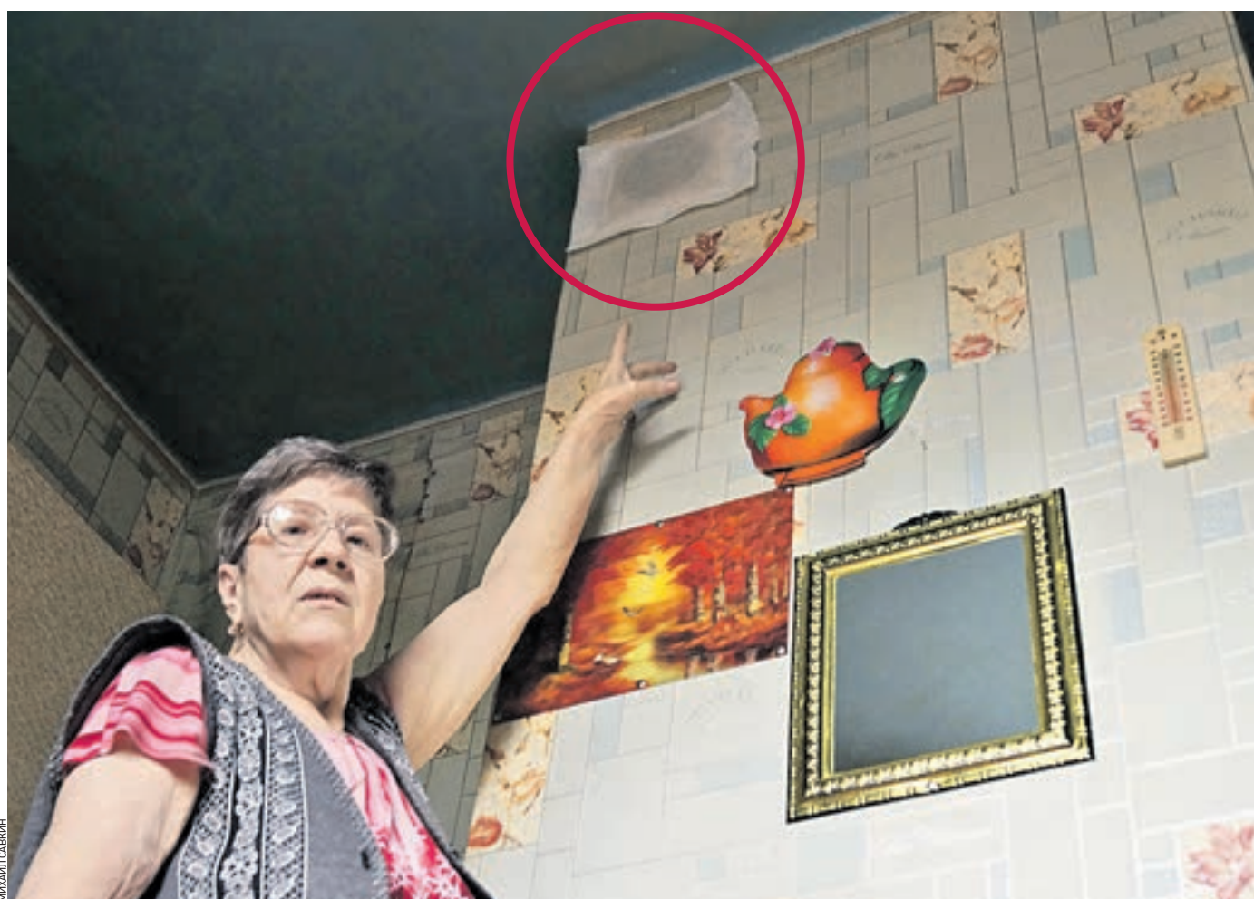
15 августа 18:02 Пенсионерка Мария Лентищева демонстрирует фотокорреспонденту «ВМ» неисправную вентиляцию в своей квартире. Из-за действий несознательного соседа женщине приходится постоянно проветривать квартиру — и летом, и зимой
