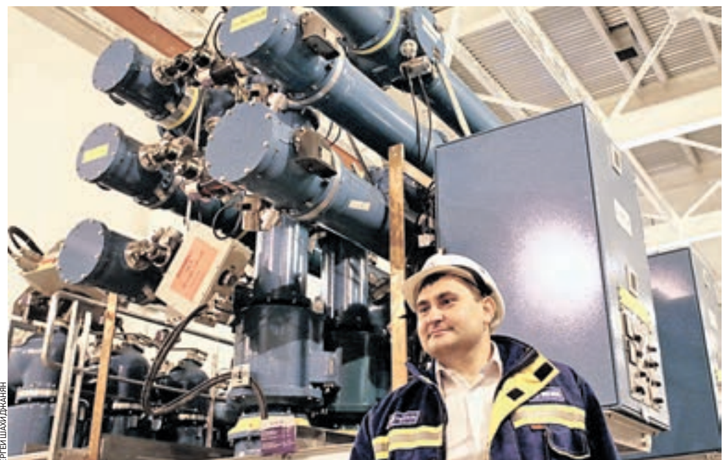
Вчера 13:01 Представитель энергетической компании Александр Дерменжи демонстрирует работу энергоблока, который будет питать электричеством парк «Зарядье». Уникальный блок, изображенный на фото, включает в себя шкафы управления и закрытые трубы, к которым подведены кабельные линии напряжением 220 киловольт
