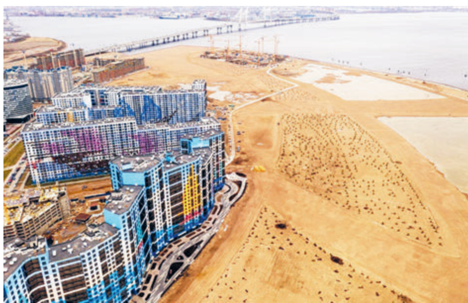
По мнению чиновников, это не море, не вода, не суша. Поэтому и разрешения на строительство не требуются.
