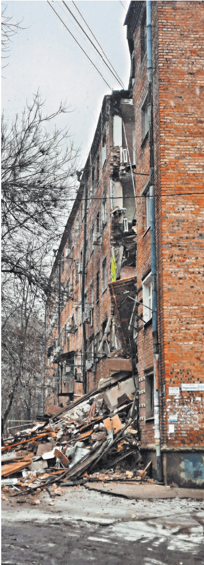
Дом 1963 года постройки уже давно дышал на ладан. В 2020 году пятиэтажку признали аварийной.
