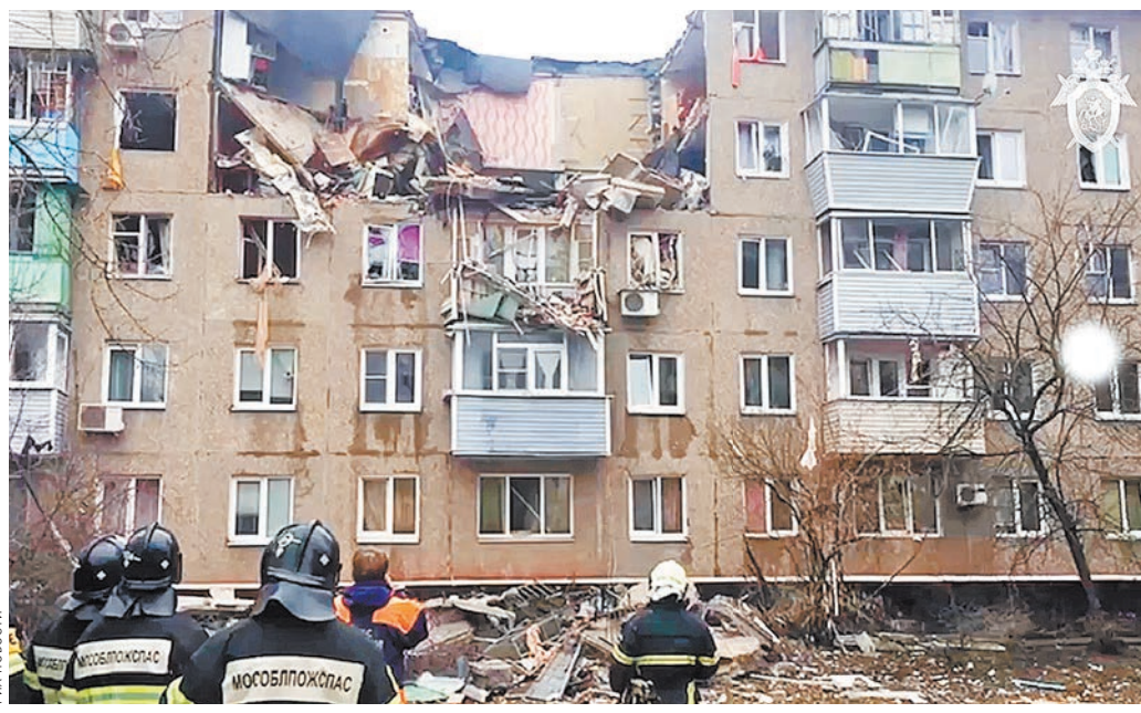
Взрыв полностью разрушил секцию из четырех квартир на 4-м и 5-м этажах дома.
