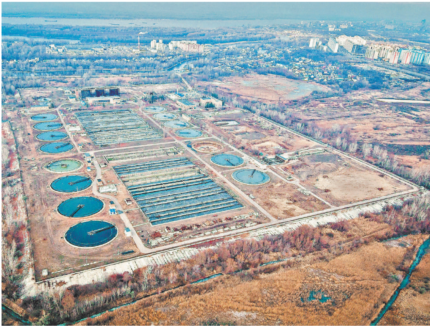
В мае в городе Новокуйбышевске Самарской области началась реконструкция очистных сооружений, существующих более 35 лет. За это время они морально и физически устарели и уже не обеспечивают необходимой чистоты воды, которую сбрасывают в реку Кривую. Кстати, она относится к объектам высшей рыбохозяйственной категории. Работы идут поэтапно без остановки непрерывного производства очистки.
