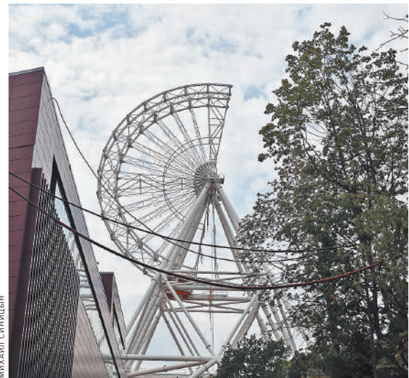
На ВДНХ уже смонтирована главная ось, к которой сейчас крепится внутреннее кольцо колеса.
