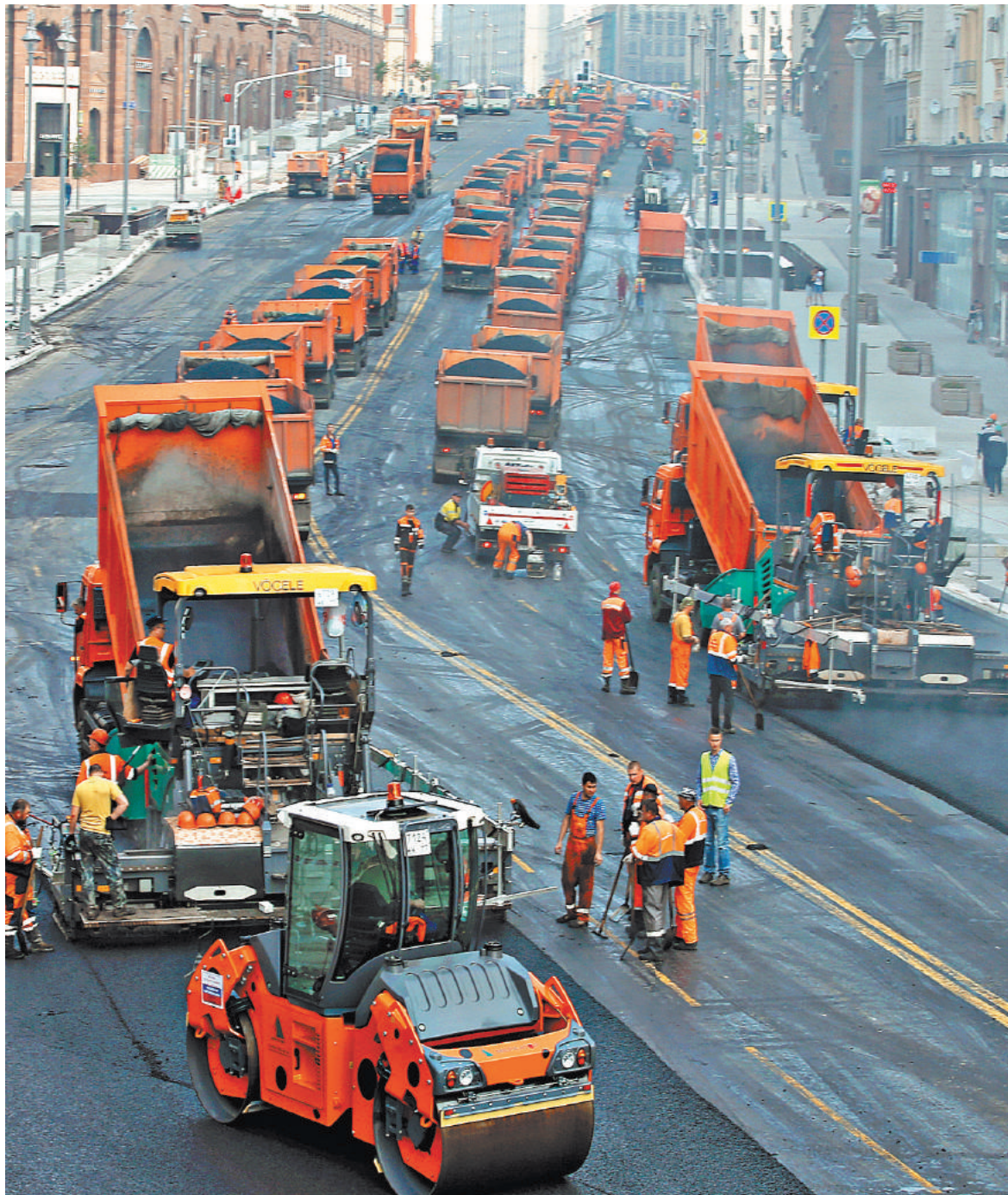
С таким размахом в прошлом году укладывали новый асфальт на Тверской улице — ее даже пришлось перекрыть. В этом году по программе «Моя улица» благоустроят вторую часть магистрали — от Пушкинской площади до Белорусского вокзала.
