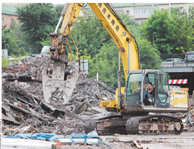
Прокуратура и комиссия по ЧС потребовали немедленно демонтировать сгоревший торговый центр.
