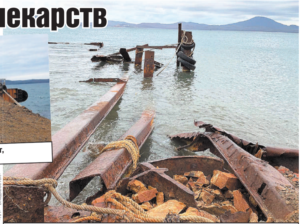
Состояние пирса до снега и обледенения.
