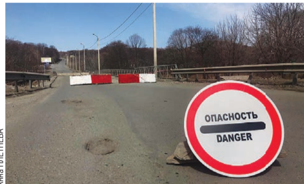
Аварийный мост на 89-м километре автомобильной дороги Артем - Находка.
