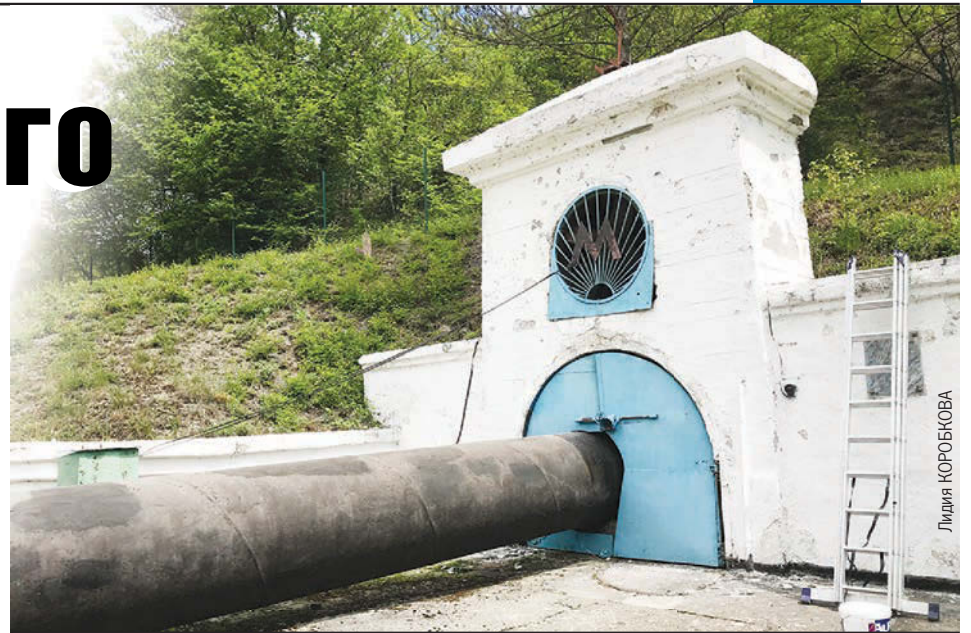
Ялтинский водовод хорошо видно с дороги, которая идет от села Счастливого в село Многоречье.
