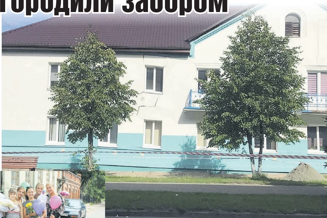
Дом на улице Вокзальной, 12, покрывается трещинами.
