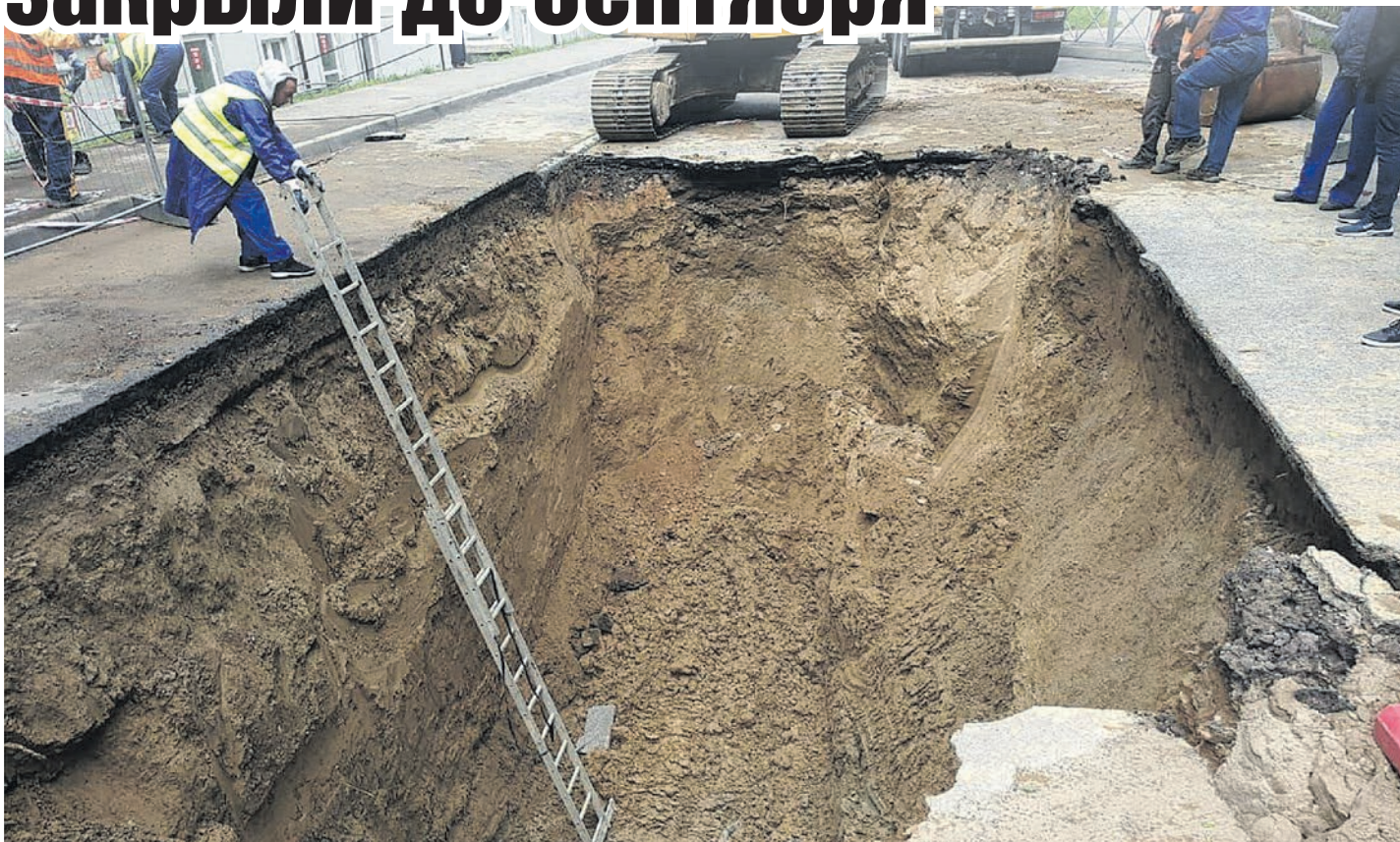
Эта эпичная яма буквально проглотила легковой автомобиль. К счастью, обошлось без пострадавших.
