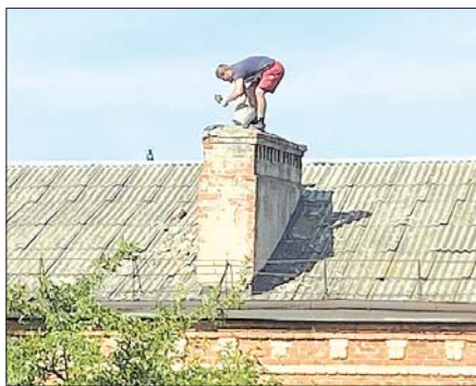
Штукатуры чинят дымоход без страховки.
