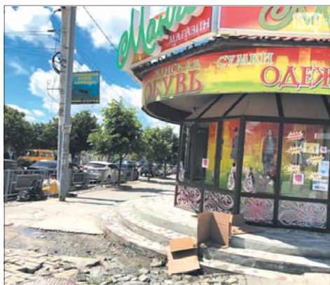
В Шахтах на площади Солдата разрушен тротуар.
