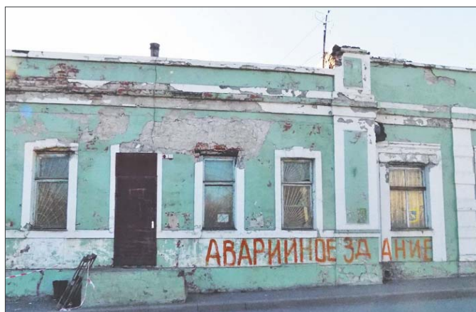
Многие здания посёлка могут быть утрачены.
