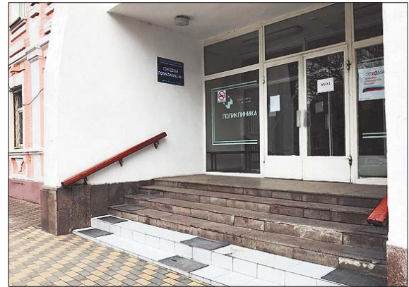
В поликлинике на ул.Пушкина отсутствует пандус.
