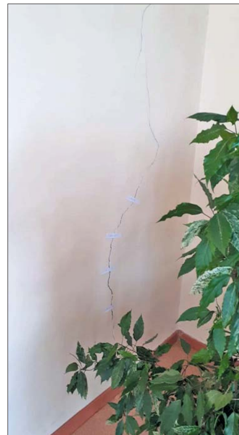
Стены учебного корпуса в трещинах, но заклеены лейкопластырем. Фото Екатерины.
