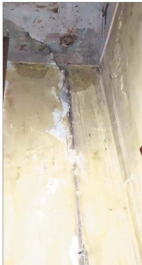
Корпус № 3 общеобразовательной школы № 5 остро нуждается в ремонте.
