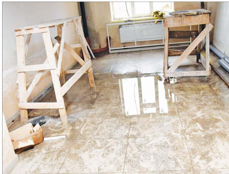
В недостроенном состоянии детский сад находится с 2014 года. Сейчас там течет крыша и затоплен коридор. Фото с сайта городской думы
